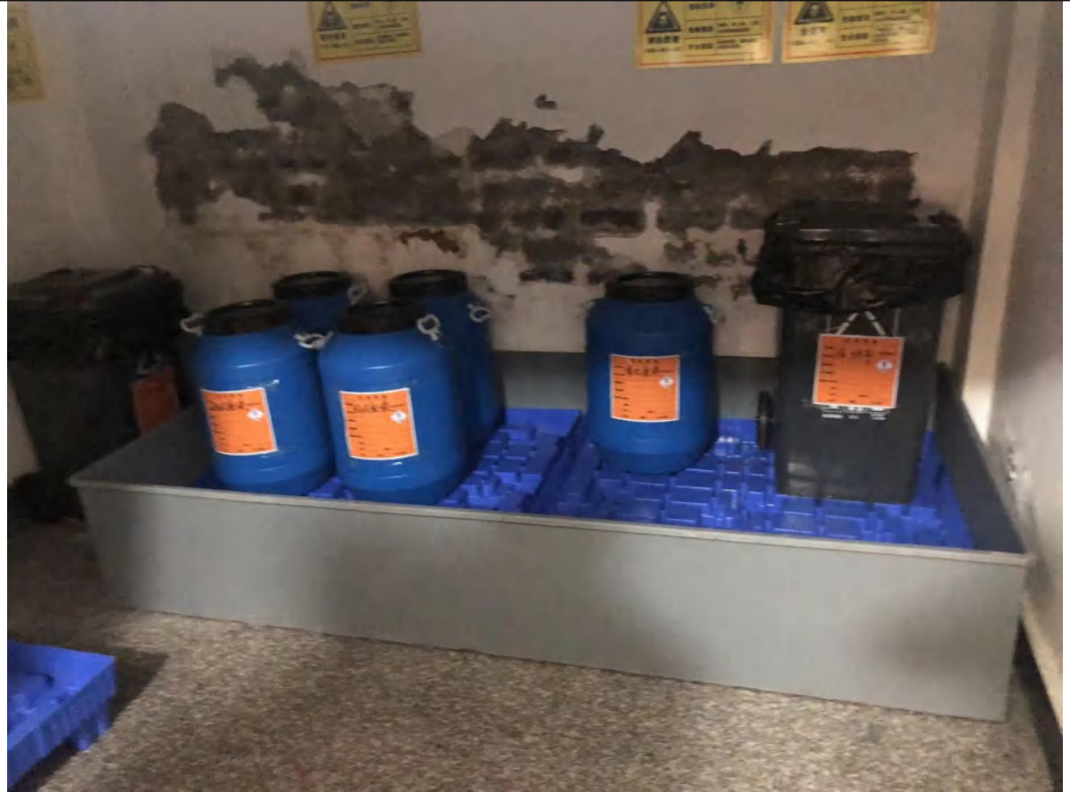
图 3-12 危废仓库防漏防渗
