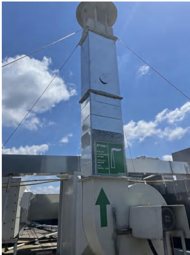
图 3-6 裁剪废气活性炭吸收装置及排气筒
