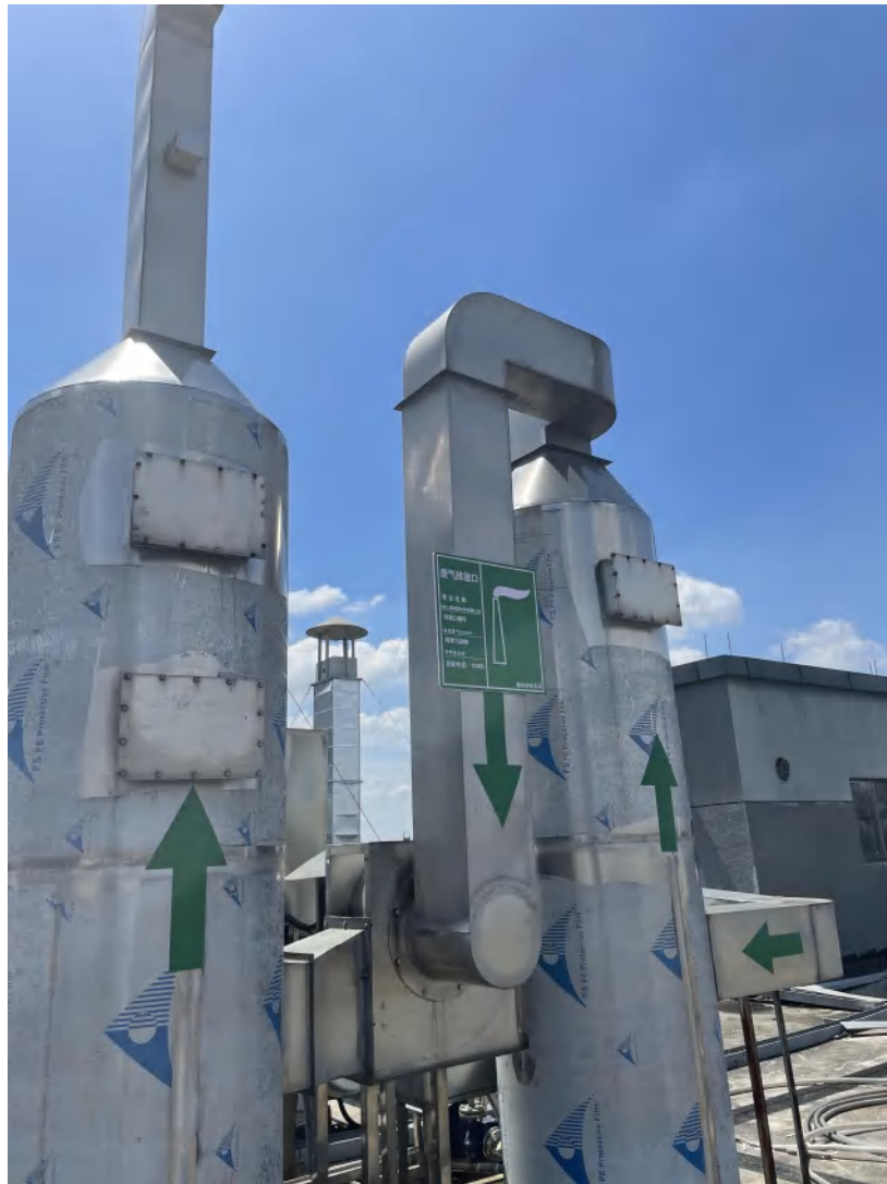
图 3-3 涂布废气二级水吸收及排气筒
