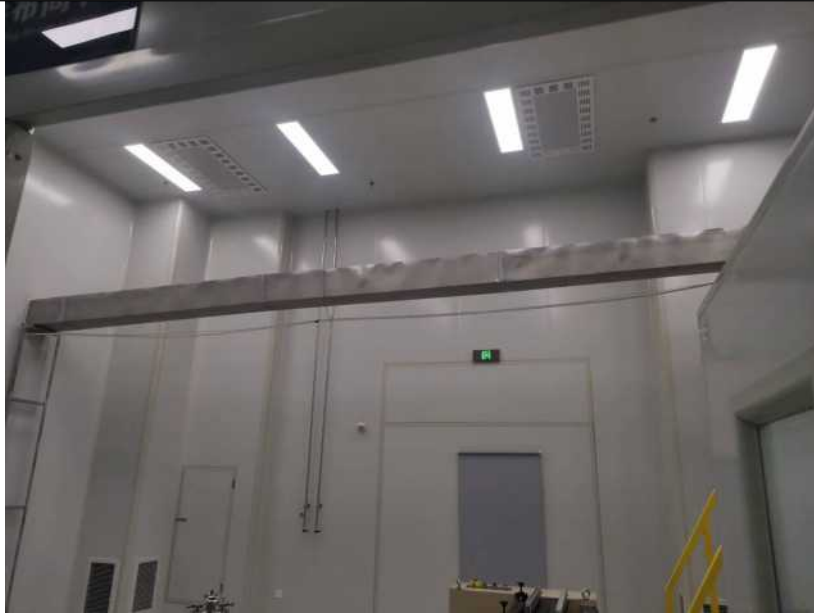
图 3-2 涂布废气管道
